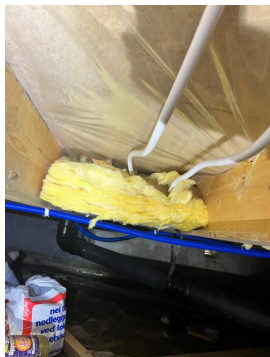
Mangler isolasjon og stubbeloft, eksponerte vannrør uten isolasjon
