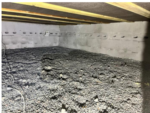
Mangler fuktsperre i den innerste delen av arealet
