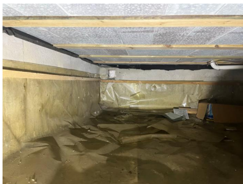
Fuktsperre er stiv og har sprekker som følge av alder.
