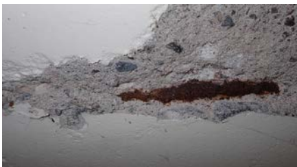
Typisk korrosjonsskade (rust)
