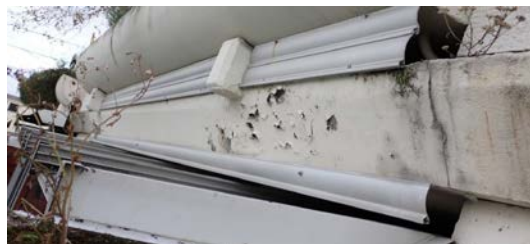
Frostskade utenfor bod
