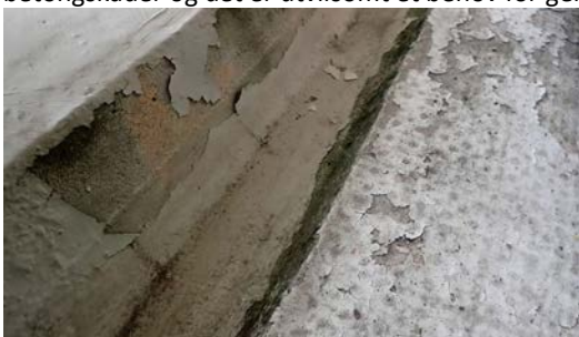
Vannrenne med epoxy
