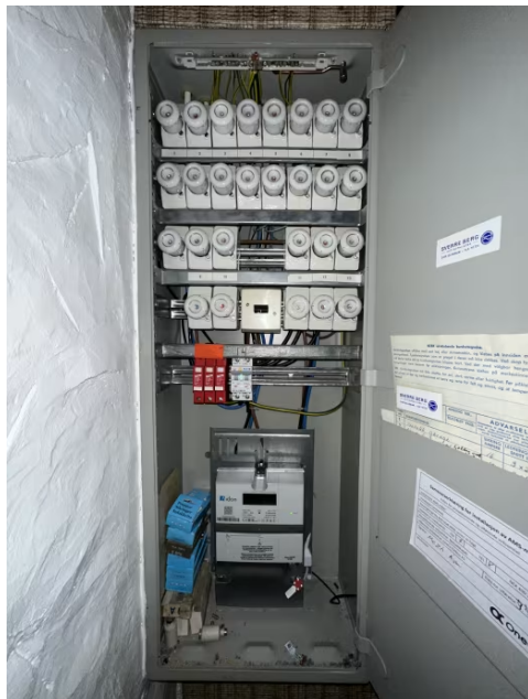
Viser sikringsskap plassert i kjeller.
