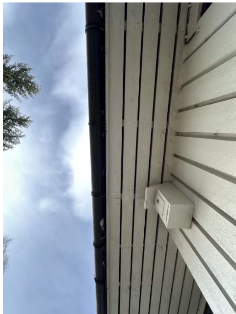
Påvist lufting ved raft uten fluenetting.
