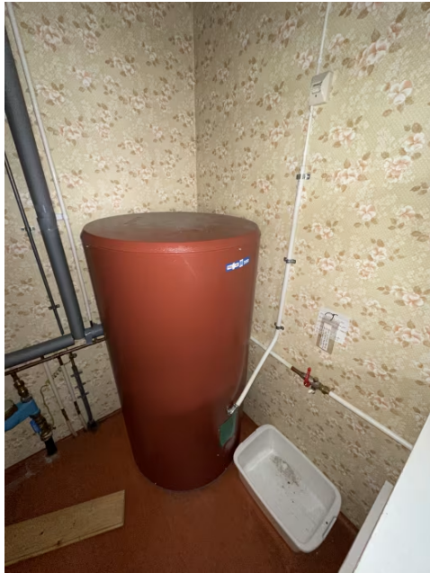
Viser bereder plassert på vaskerom i kjeller.
