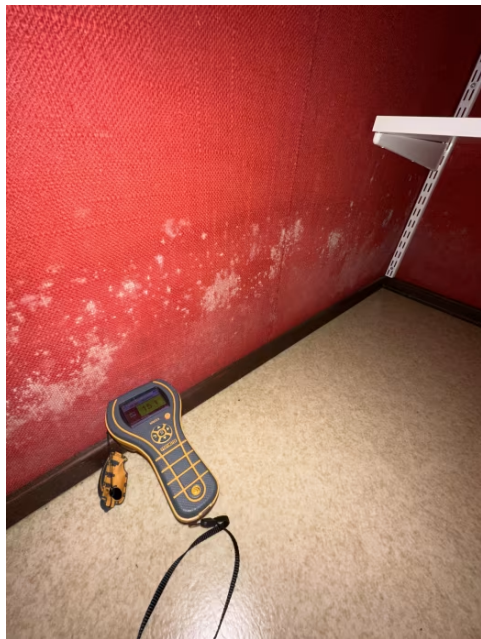
Det registreres salutslag på plater i kjellerom.
