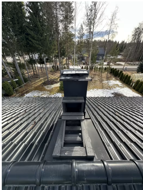
Helbeslått pipe over tak.
