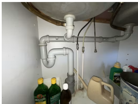
Viser vann og avløpsinnstallasjoner under kum.
