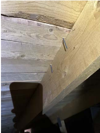
Det registreres stedvis spiker igjennom undertaket.
