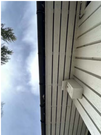
Påvist lufting ved raft uten fluenetting.
