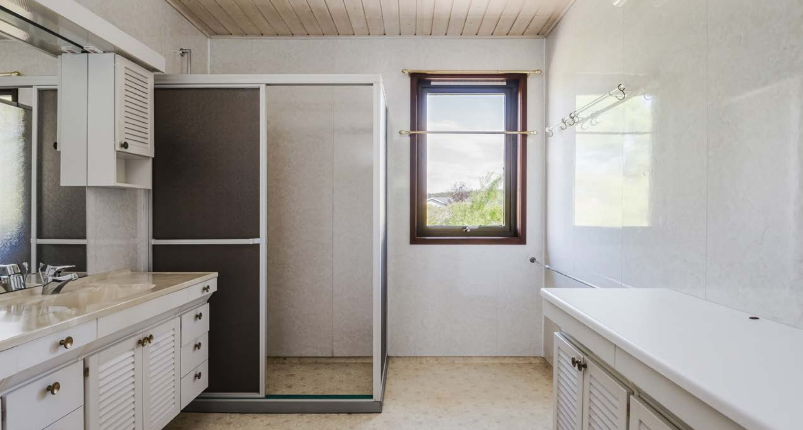
Eldre baderom som har fått TG3 og har behov for totalrenovering.
