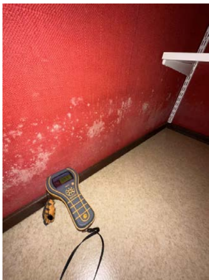
Det registreres salutslag på plater i kjellerom.
