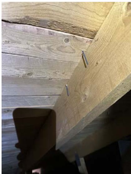
Det registreres stedvis spiker igjennom undertaket.
