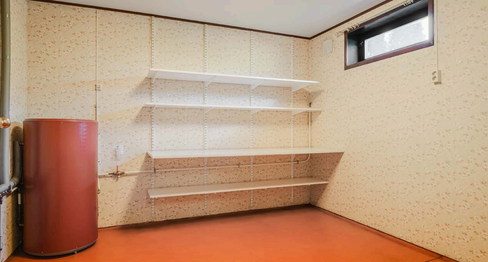
Eldre vaskerom i kjelleren med behov for totalrenovering.
