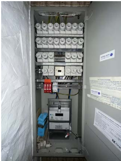
Viser sikringsskap plassert i kjeller.
