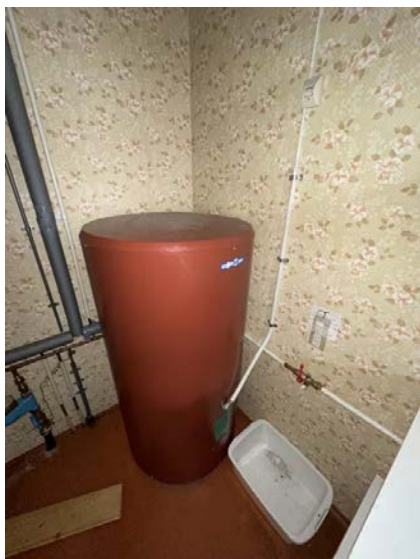
Viser bereder plassert på vaskerom i kjeller.
