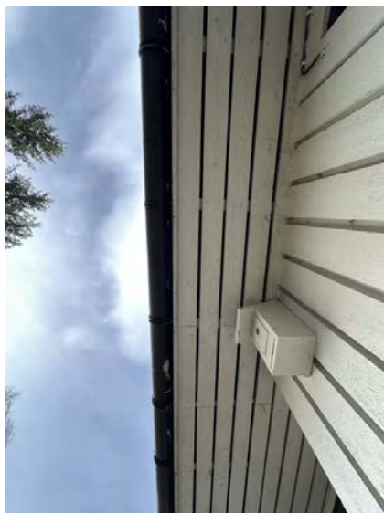
Påvist lufting ved raft uten fluenetting.
