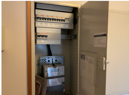
El-anlegg med automatsikringer. Åpent og skjult ledningsnett. Sikringsskapet er plassert i felles gang.
