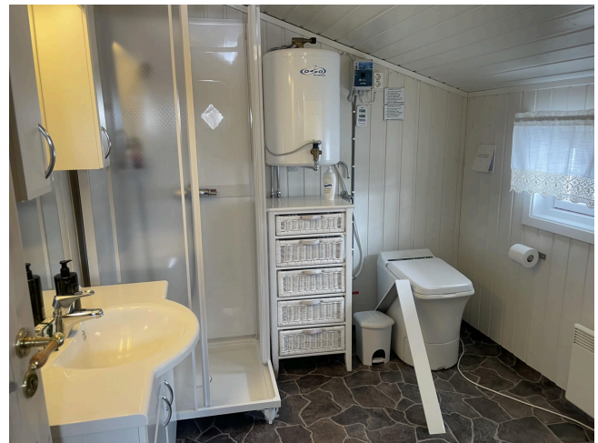
Våtsone vegg er ikke etablert ved vask og dusjsone.
