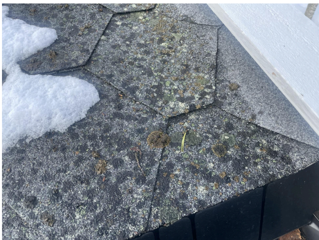
Det er påvist mose på taktekking.
