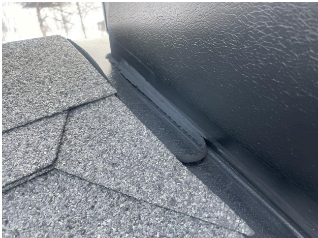
Fuge rundt pipe er i dårlig forfatning.
