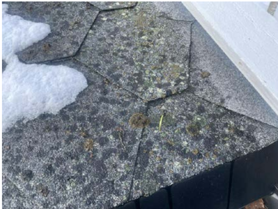
Det er påvist mose på taktekking.
