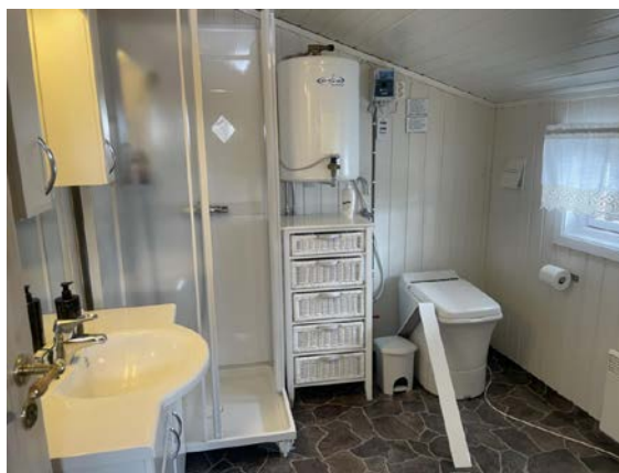
Våtsone vegg er ikke etablert ved vask og dusjsone.
