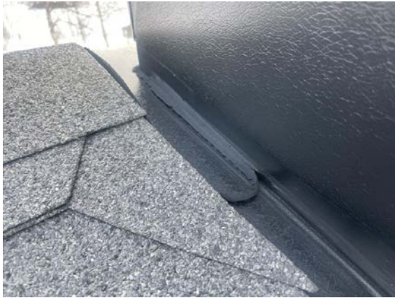
Fuge rundt pipe er i dårlig forfatning.
