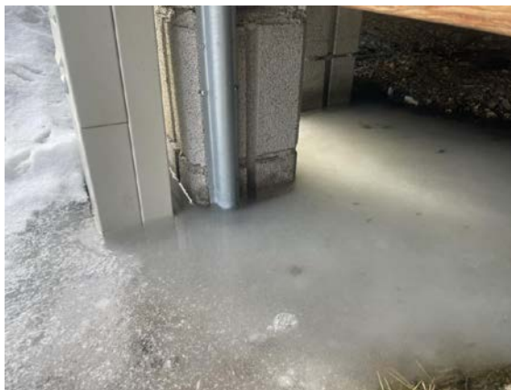
Terrenget er ikke riktig planert.
