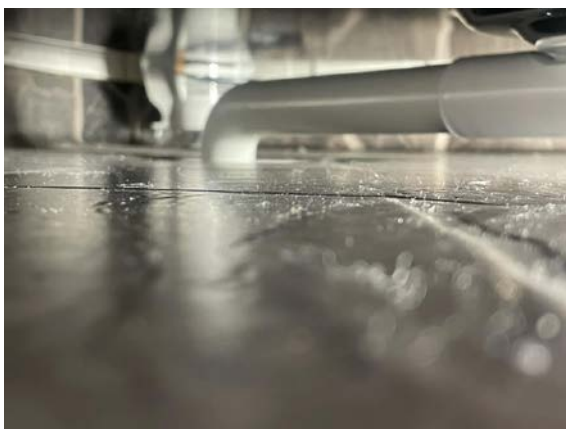
Det er fare for vannansamling på gulvet. Det er ikke fall til sluk.
