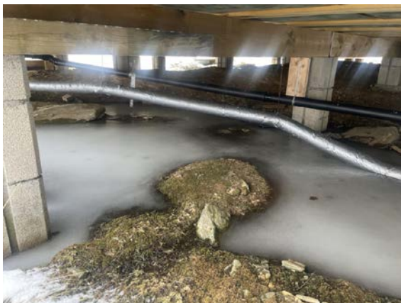
Terrenget er ikke riktig planert.
