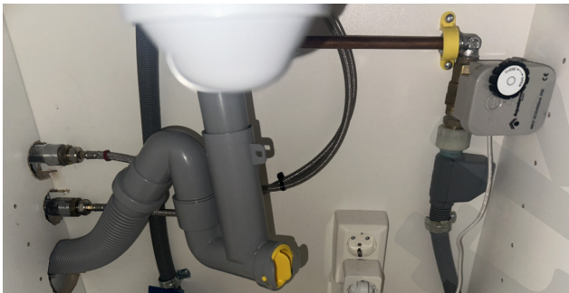
Røropplegg i kjøkkenbenk med Waterguard
