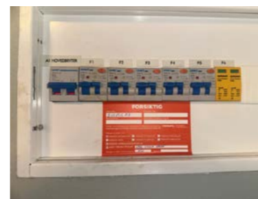
Sikringsskap med automatsikringer.
