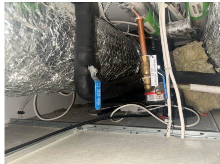
Stoppekraner plassert i felles gang.
