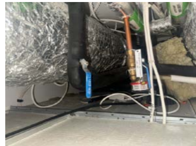
Stoppekraner plassert i felles gang.
