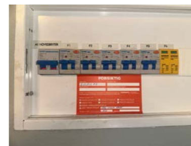
Sikringsskap med automatsikringer.
