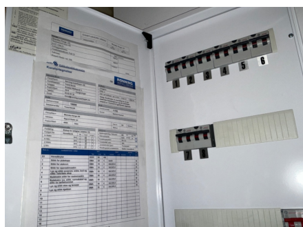
Automatsikringer i sikringskap plassert i bod.
