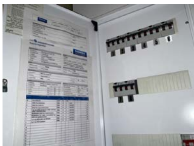
Automatsikringer i sikringsskap plassert i bod.
