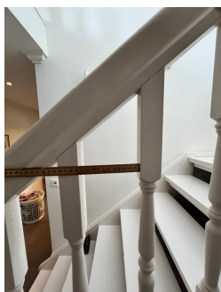
Åpning i rekkverk opptil ca 12 cm
