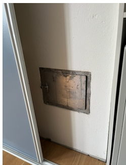
Mangler ubrennbar plate på gulv
