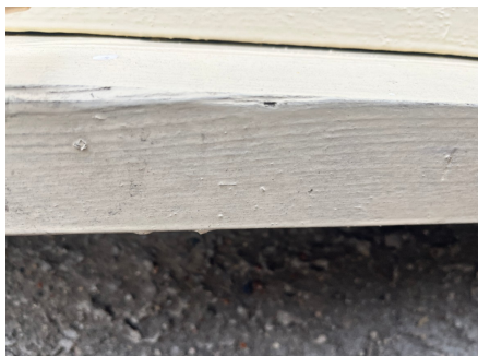
Minimalt med lufting i nedkant på vegg.
