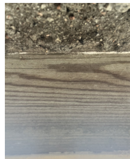
Bilde under vannstokk i bunn på vegg. Ingen lufting.
