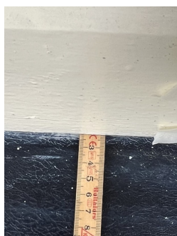
Beslag ligger med oppbrett direkte bak bordkledningen.
