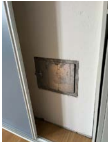
Mangler ubrennbar plate på gulv
