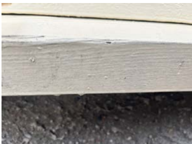
Minimalt med lufting i nedkant på vegg.
