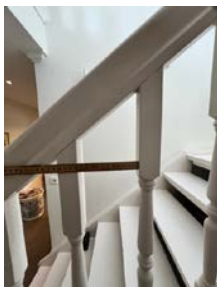
Åpning i rekkverk opptil ca 12 cm
