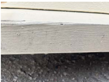
Minimalt med lufting i nedkant på vegg.
