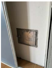
Mangler ubrennbar plate på gulv
