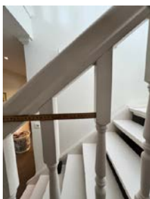
Åpning i rekkverk opptil ca 12 cm
