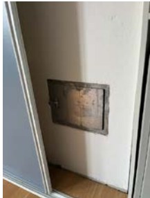
Mangler ubrennbar plate på gulv
