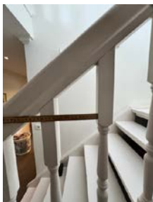
Åpning i rekkverk opptil ca 12 cm
