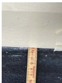
Beslag ligger med oppbrett direkte bak bordkledningen.
