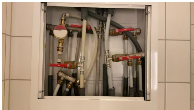
Rørskap. Det mangler sprutsikring.
