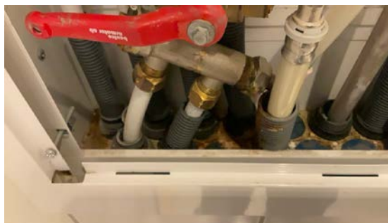
Overflaterust i skapet.
