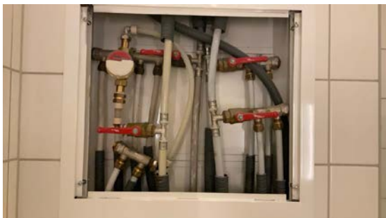
Rørskap. Det mangler sprutsikring.
