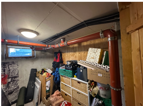
Avløpsrør i kjelleren
