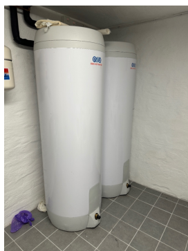
Sentralanlegg for varmtvann i vaskekjeller
