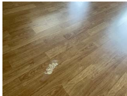
Skadet laminat i stuen
