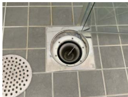
Sluk i nedsenket hjørne
