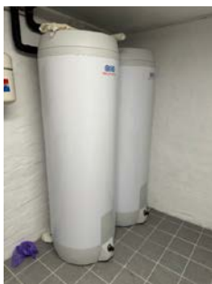
Sentralanlegg for varmtvann i vaskekjeller
