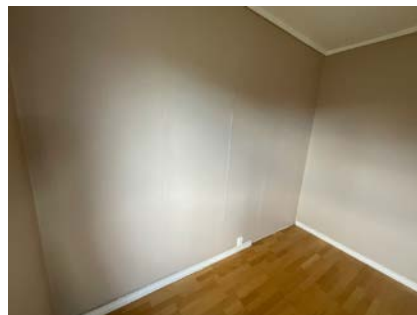
Sprekk i tapeten på soverommet
