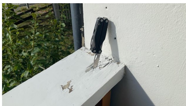
Råte på håndløper.
