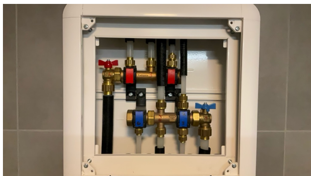
Rørskap med stoppekraner.
