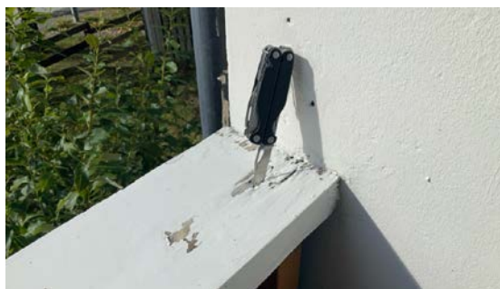
Råte på håndløper.
