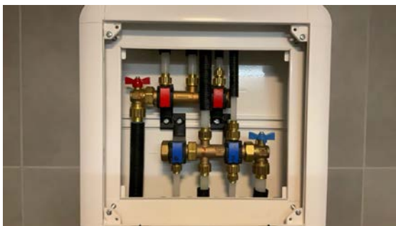
Rørskap med stoppekraner.
