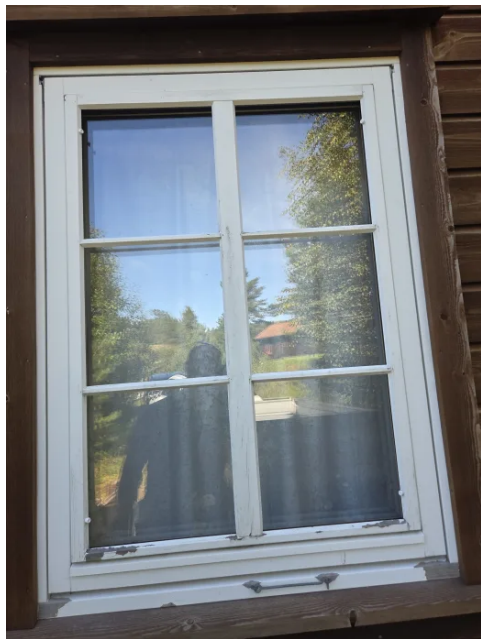
Eksempelbilde vindu. Noe værslitt.
