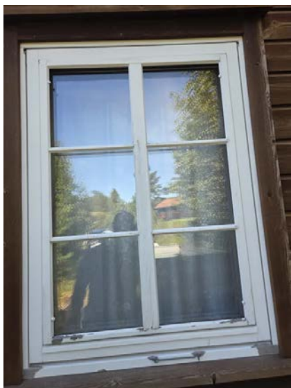
Eksempelbilde vindu. Noe værslitt.
