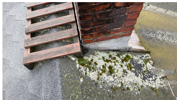
Mose ved pipe.
