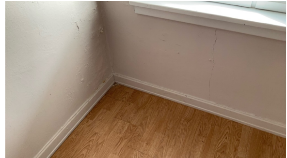
Sprekk i grunnmur/puss på soverom.
