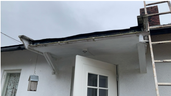
Boe defekte takrenner over i inngangsparti.
