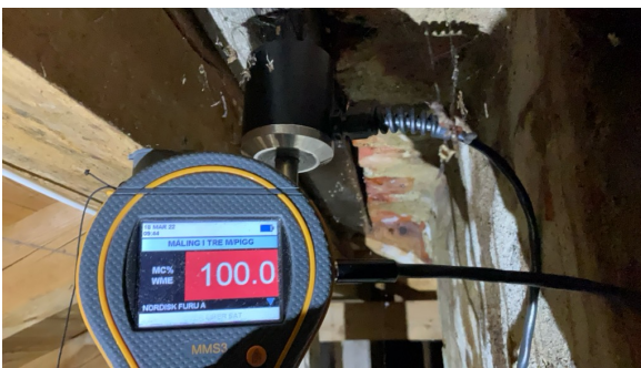
Lekkasje rundt pipe.
