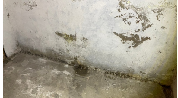
Fukt på yttervegg under terreng.
