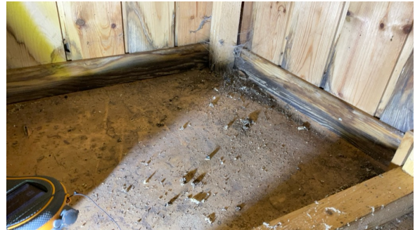
Misfarging på treverk i kjeller.
