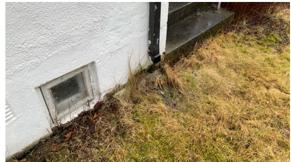
Takvann ikke ledet bort fra grunnmur.
