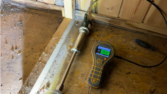
Fuktmåling i panel i bod i underetasjen.
