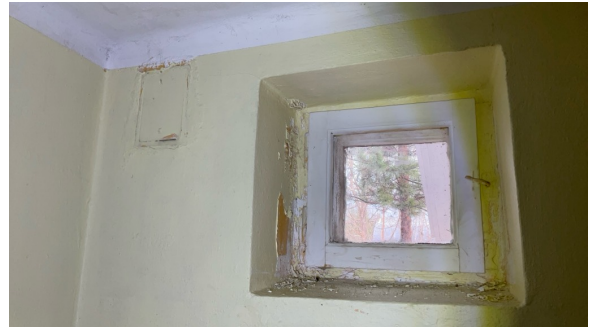
Vindu med innvendig kondensskader,
