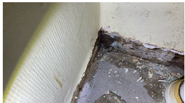
Fukt på bad i overgang gulv/vegg.
