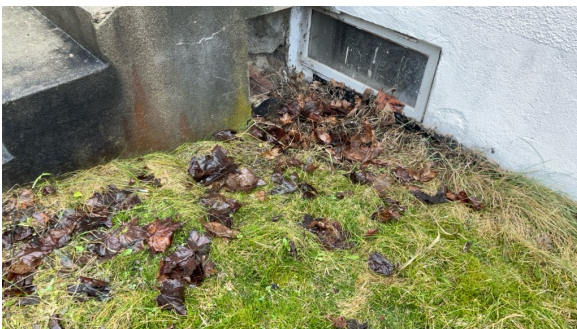
Lokalt fall mot grunnmur.
