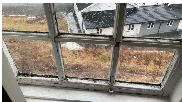
Fuktskade på vindu på bad.
