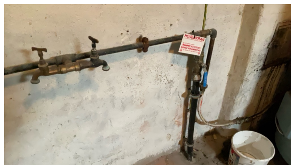
Stoppekran i kjeller.
