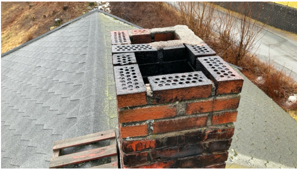
Pipe uten topphatt.
