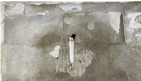
Løs puss på betongblokker i utvendig bod.
