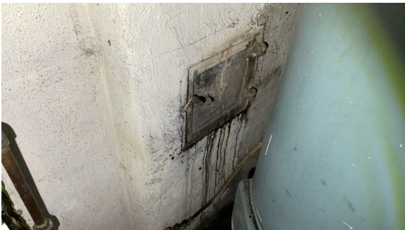
Sotluke med sotvann i kjelleren
