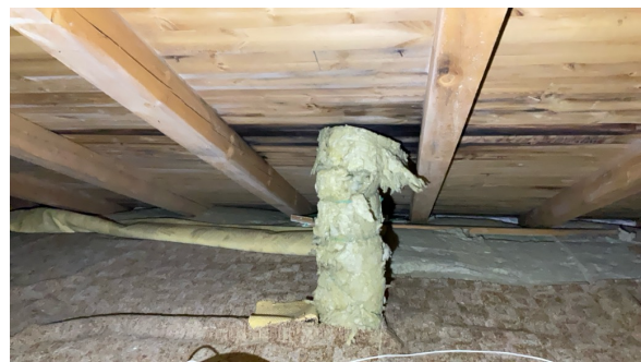
Manglende lufting ut mot yttervegg.
