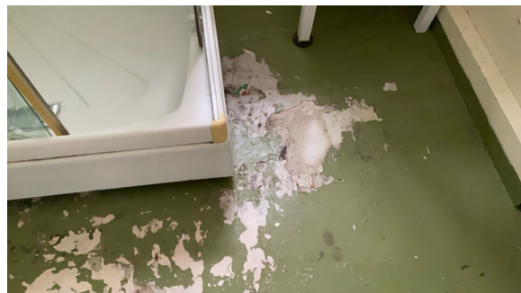
Løs maling på betongdekke.
