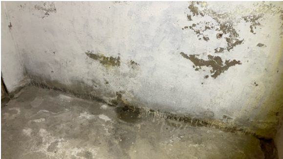
Fukt på kjellervegg.
