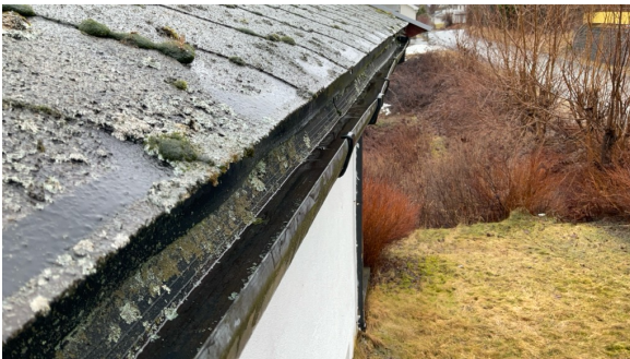
Tidsmessig slitasje på takrenner.
