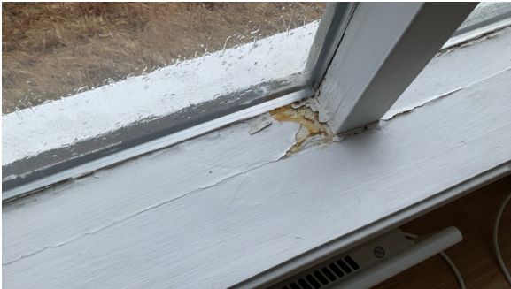
Kondensskade på stuevindu.
