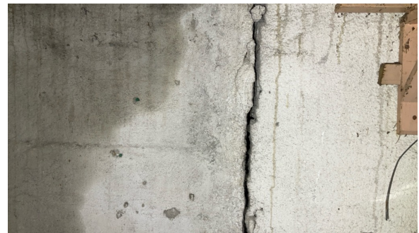
Sprekk i grunnmur.
