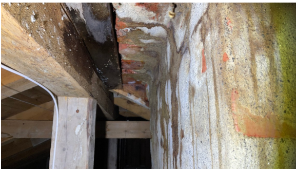
Fukt ved pipe.
