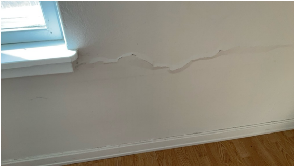
Sprekk i mur og fuktsvelling i soverom i underetasjen.
