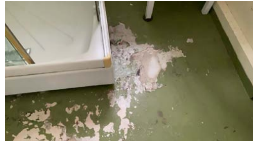
Løs maling på betongdekke.
