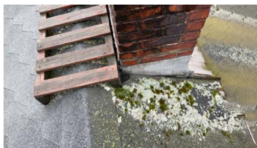
Mose ved pipe.
