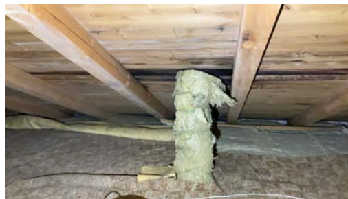
Manglende lufting ut mot yttervegg.
