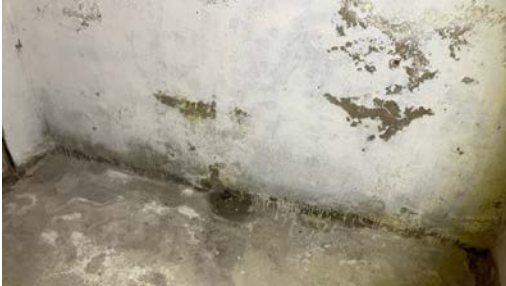
Fukt på kjellervegg.
