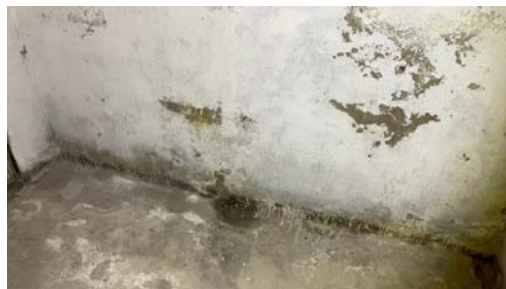
Fukt på yttervegg under terreng.
