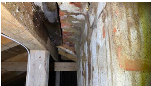
Fukt ved pipe.
