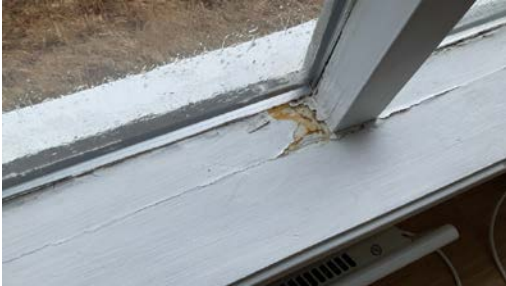
Kondensskade på stuevindu.
