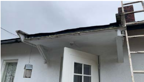
Boe defekte takrenner over i inngangsparti.
