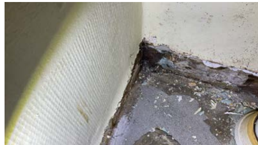
Fukt på bad i overgang gulv/vegg.
