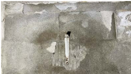
Løs puss på betongblokker i utvendig bod.
