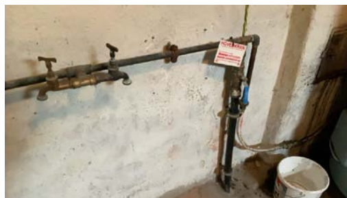
Stoppekran i kjeller.
