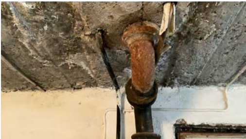
Rust på avløpsrør i støpejern.
