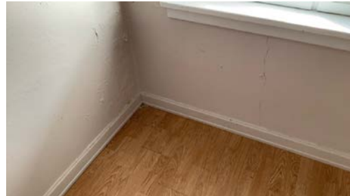
Sprekk i grunnmur/puss på soverom.
