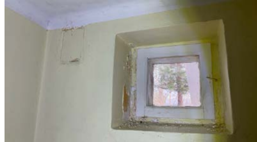
Vindu med innvendig kondensskader,
