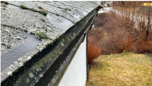
Tidsmessig slitasje på takrenner.
