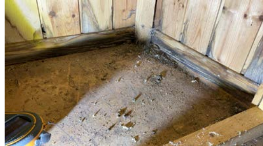
Misfarging på treverk i kjeller.
