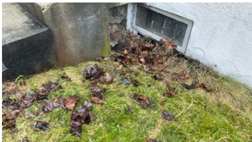
Lokalt fall mot grunnmur.
