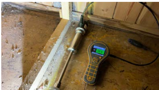
Fuktmåling i panel i bod i underetasjen.
