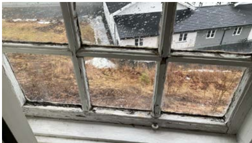
Fuktskade på vindu på bad.
