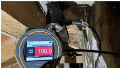
Lekkasje rundt pipe.
