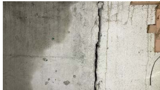
Sprekk i grunnmur.
