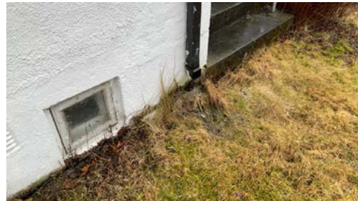
Takvann ikke ledet bort fra grunnmur.
