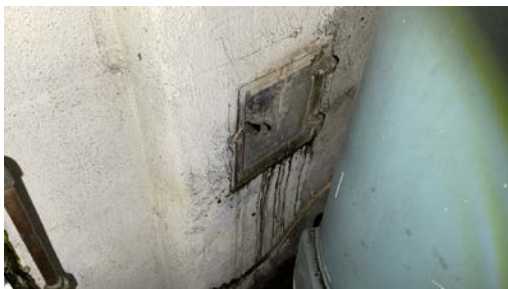
Sotluke med sotvann i kjelleren
