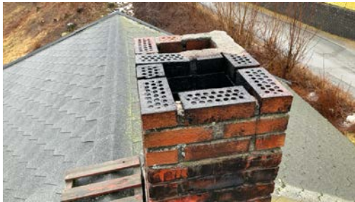
Pipe uten topphatt.
