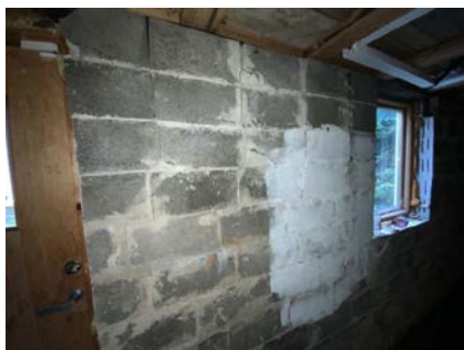
Synlige riss i grunnmur.
