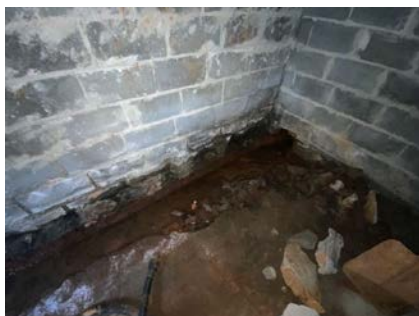
Synlig vann i kjeller.
