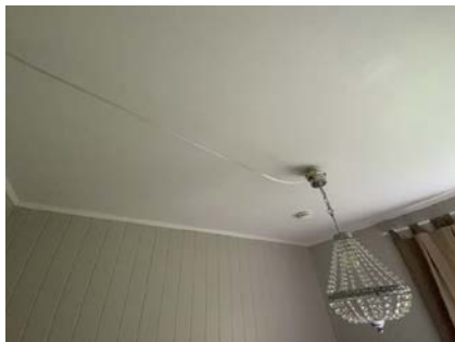
Lampeledning på soverom i 1.etg må festes.
