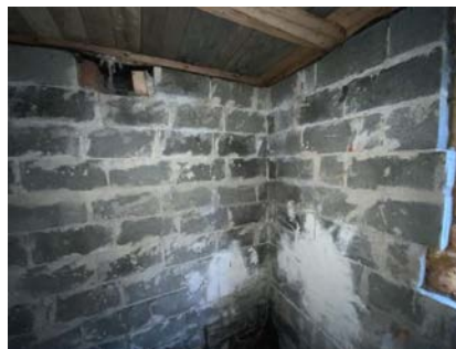
Synlige riss i grunnmur.
