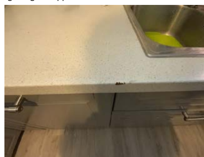
Skade på benkeplate.
