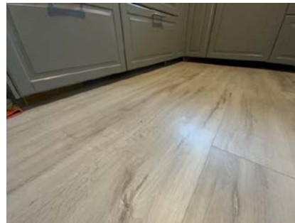
Sokler mangler og må opparbeides.
