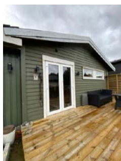
Høyde opp fra terrasse til terskel er noe lav der metallrist bør felles ned for tilfredsstillende avrenning.
