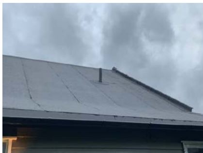
Ventilhatt mangler. Isbord med blikk må etableres.
