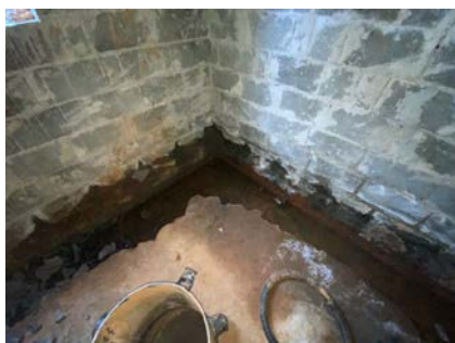
Synlig vann i kjeller.
