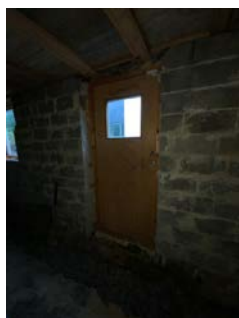
Synlig elde og manglende belisting.
