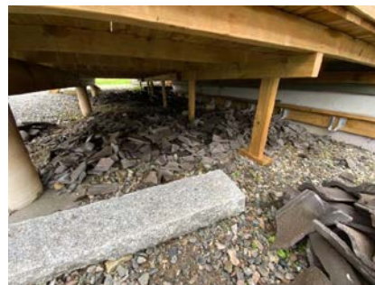
Avstivning er bygget direkte på grunn og bør holdes under oppsikt. Kommende utbedringer er påregnelig.
