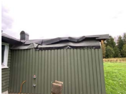
Avslutninger bør utbedres.
