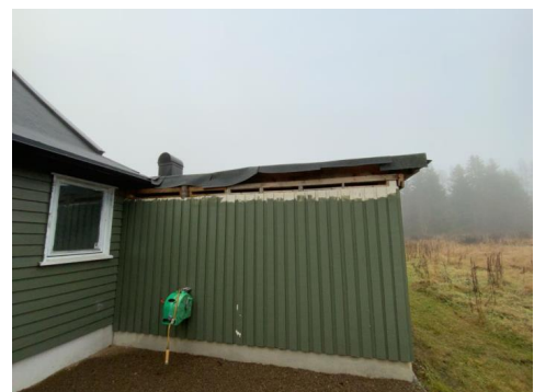
Utbedringer av overganger av taktekke på garasjen bør utføres.
