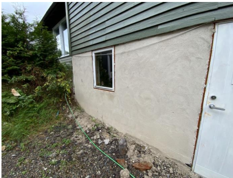
Manglende belisting på kjellervinduer.
