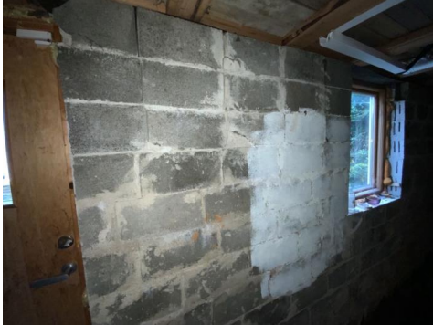
Synlige riss i grunnmur.
