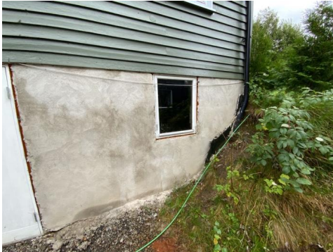
Manglende belisting på kjellervinduer.
