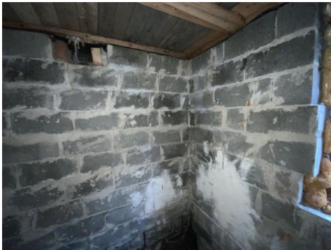
Synlige riss i grunnmur.
