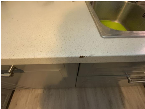
Skade på benkeplate.
