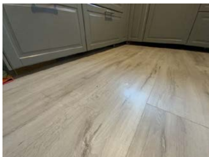
Sokler mangler og må opparbeides.
