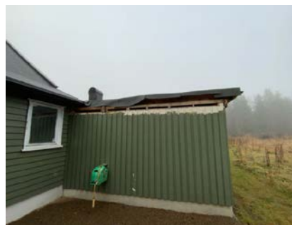
Utbedringer av overganger av taktekke på garasjen bør utføres.
