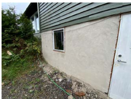
Manglende belistning på kjellervinduer.
