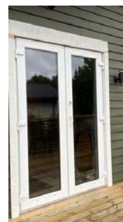
Høyde opp fra terrasse til terskel er noe lav der metallrist bør felles ned for tilfredsstillende avrenning.
