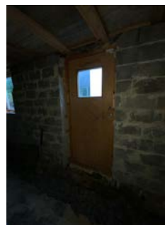
Synlig elde og manglende belistning.
