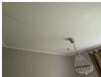
Lampeledning på soverom i 1.etg må festes.
