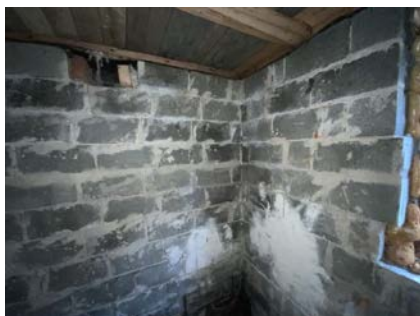
Synlige riss i grunnmur.
