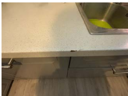
Skade på benkeplate.
