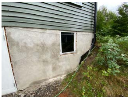
Manglende belistning på kjellervinduer.
