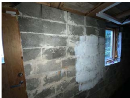
Synlige riss i grunnmur.
