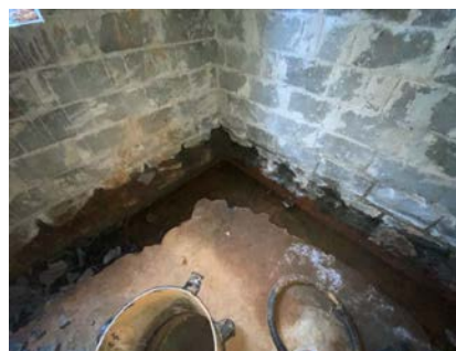
Synlig vann i kjeller.
