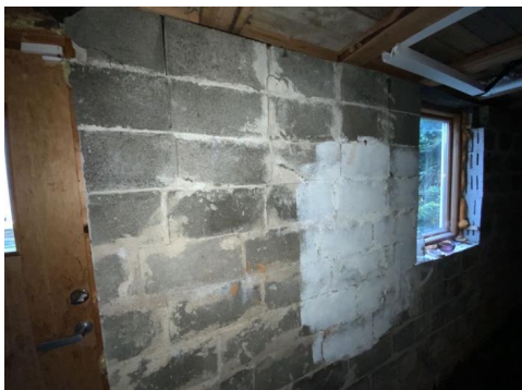
Synlige riss i grunnmur.
