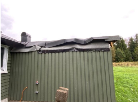
Avslutninger bør utbedres.
