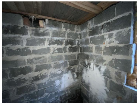
Synlige riss i grunnmur.
