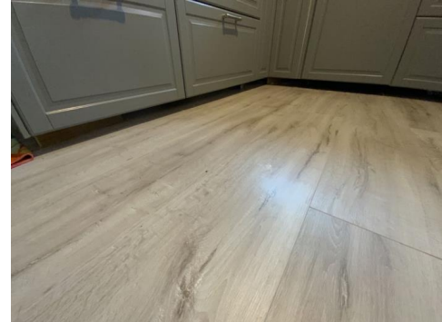
Sokler mangler og må opparbeides.
