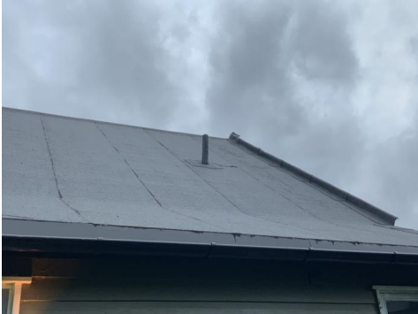
Ventilhatt mangler. Isbord med blikk må etableres.
