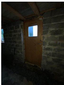
Synlig elde og manglende belisting.
