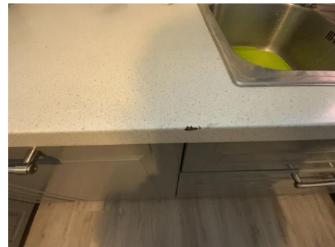
Skade på benkeplate.
