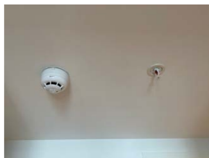
Brannvarsler og slukkehode for sprinkleranlegg.
