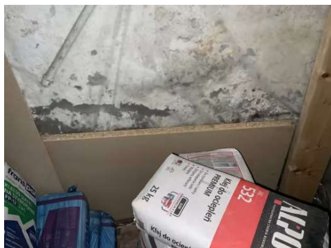
Malingsavskalling i nedre del av grunnmur. Fukt på plast mot grunnmur.
