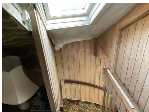
Lekkasje fra takvindu.
