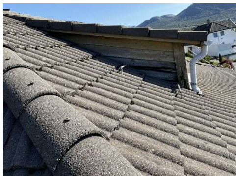
Råte i sidevegg på takoppløft.
