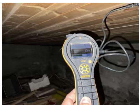
13,4% fukt i himling i krypkjeller er akseptabelt nivå og anses som tørt.
