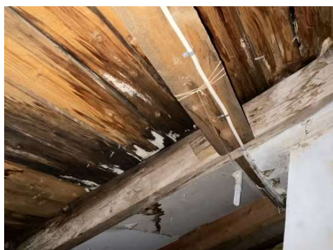
Merker etter lekkasje.
