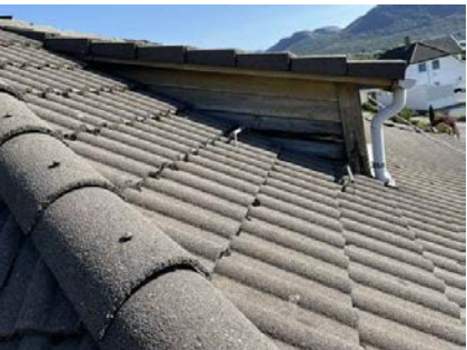
Råte i sidevegg på takoppløft.
