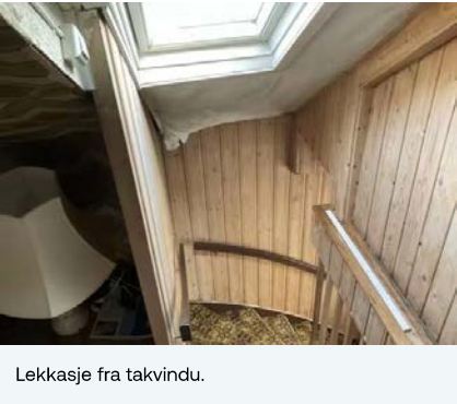
Merker etter lekkasje.
