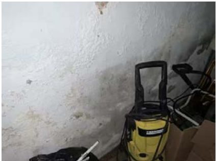
Malingsavskalling og kalkutsalg tyder på fukt i grunnmuren.
