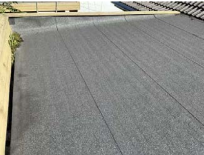
Det er god skrå på taket. Vannet renner til takrenne som er montert ytterst i gesimskasse som er utenfor veggliv. Det mangler overløp.
