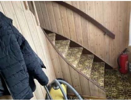
Det mangler rekkverk nederst på trappen til loft.
