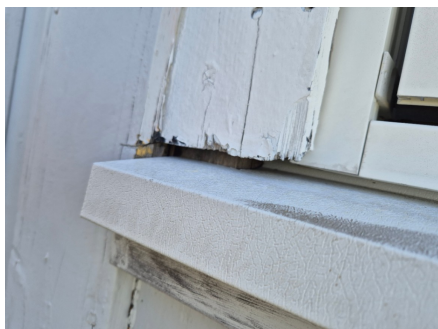
Ingen oppkant av beslag bak list.
