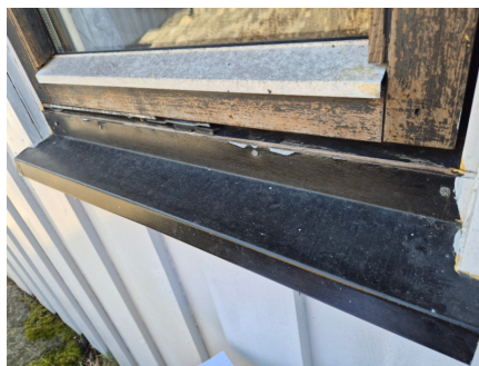
Beslag er ikke ført i sporet under vinduskarm.
