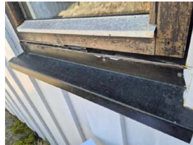
Beslag er ikke ført i sporet under vinduskarm.
