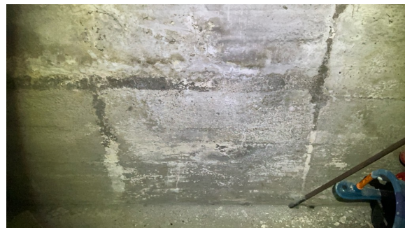
Saltutslag på mur.
