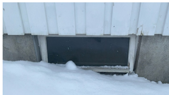
Lav høyde mellom terreng og kjellervinduer.
