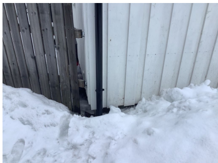
Svertesopp er registrert på deler av kledning.
