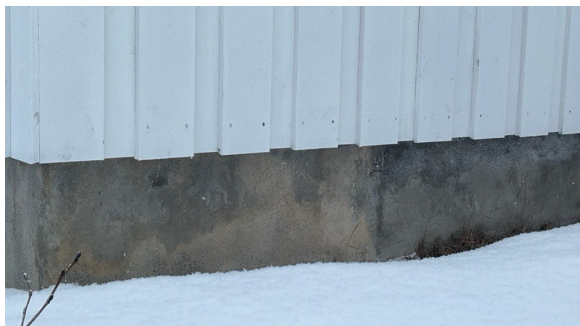
Fuktmerker på innvendig og utvendig mur er registrert.
