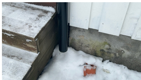
Nedløp ledes ikke vekk fra grunnmur.
