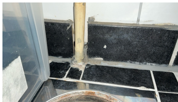
Det er gamle vannrør til våtrommet, ingen dokumentasjon som viser løsning for gjennomføringer i våtsone.
