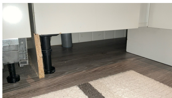
Manglende sokkel under innredning.
