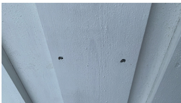
Feil spikring av kledning, dette forringer kledningens funksjonstid da fukt trekker inn ved spikerhull.
