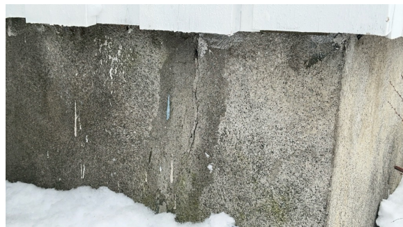
Sprekk i grunnmur registrert.
