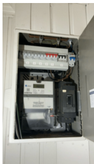
Sikringsskap 2. et med strømmåler.
