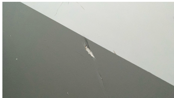
Skade i vegg, trappegang til 2. etasje.
