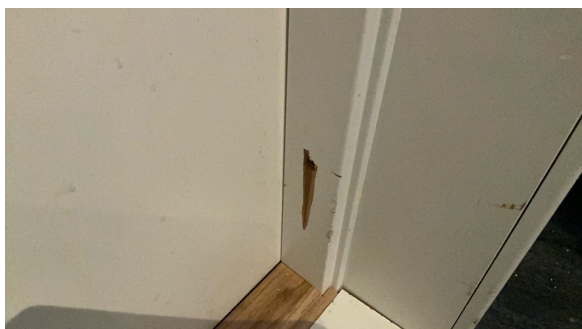
Skade i karm på dør.
