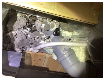
Ufagmessig utførelse observert på rørledninger under våtrom.
