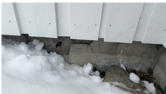
Løs puss på mur er registrert.
