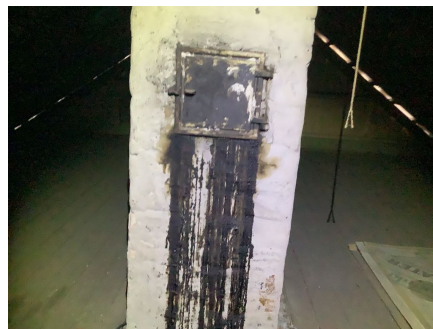
Rennemerker fra feieluke på loft.
