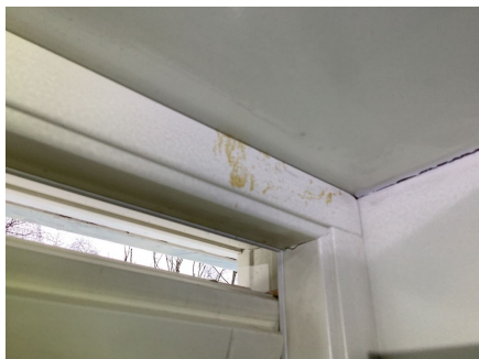
Byggeskum på vinduskarm.
