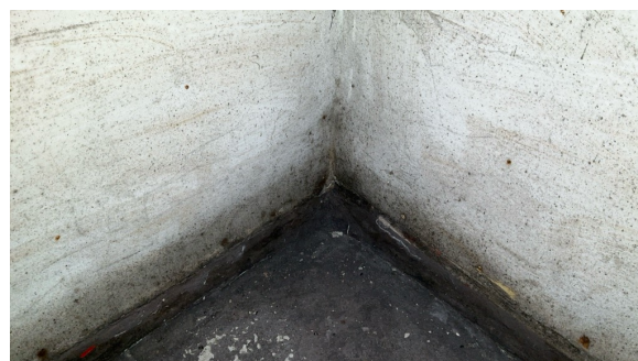
Muggsoppvekst, særlig synlig nederst på vegg mot gulv. Rom har påført vegg med synlige fuktskader.
