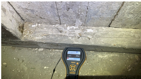
Fuktmålinger i treverk mot betonggulv viser skadelig fuktverdi. Det er registrert fuktskader i treverk.
