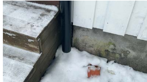
Nedløp ledes ikke vekk fra grunnmur.
