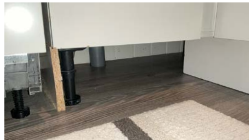
Manglende sokkel under innredning.
