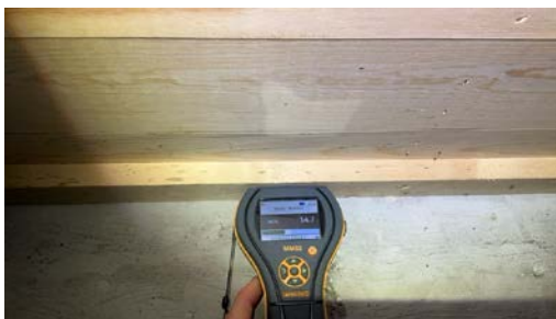
Fuktmåling med pigger i nyere kjellerhimling av tre viser ingen unormale verdier. Målingen er utført som en stikktakning og sier kun noe om verdiene der målingen er utført.
