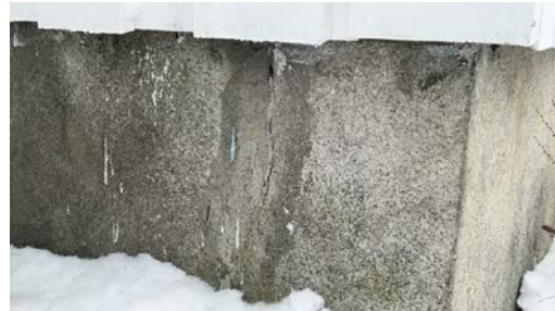
Sprekk i grunnmur registrert.
