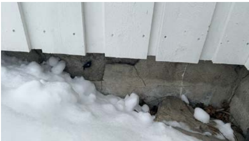
Løs puss på mur er registrert.
