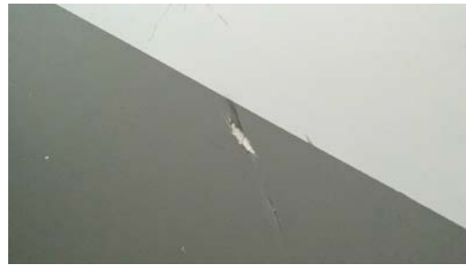
Skade i vegg, trappegang til 2. etasje.
