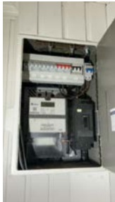
Sikringsskap 2. et med strømmåler.
