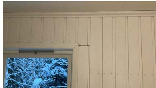
Ufagmessig utførelse på innvendige overflater er registrert.
