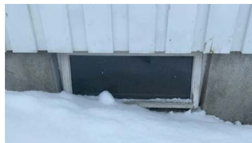
Lav høyde mellom terreng og kjellervinduer.
