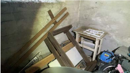
Organiske materialer ligger direkte mot grunn/mur.
