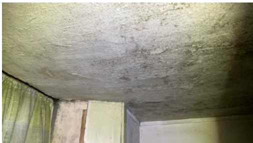
Muggsoppvekst i deler av kjellerhimling.
