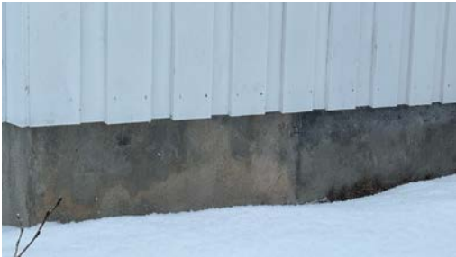
Fuktmerker på innvendig og utvendig mur er registrert.
