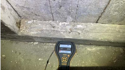
Fuktmålinger i treverk mot betonggulv viser skadelig fuktverdier. Det er registrert fuktskader i treverk.
