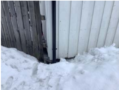
Svertesopp er registrert på deler av kledning.
