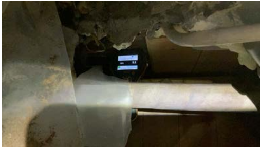
Fuktmåling i treverk, ingen forhøyede verdier er målt.
