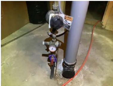
Hovedstoppekran og vannmåler.
