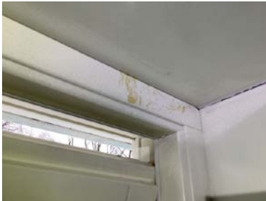
Byggeskum på vinduskarm.
