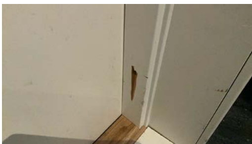
Skade i karm på dør.
