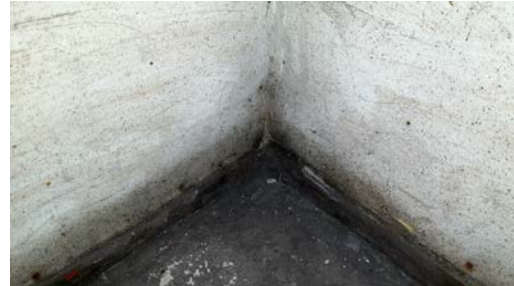
Muggsoppvekst, særlig synlig nederst på vegg mot gulv. Rom har påført vegg med synlige fuktskader.
