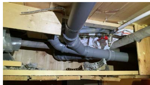
Åpninger i etasjeskille/kjellerhimling hvor skadedyr/mus kan ta seg inn.
