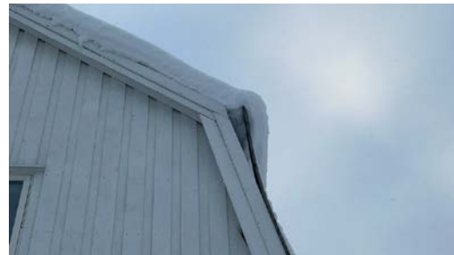
Løst isbord på vindskie er registrert.
