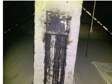
Rennemerker fra feiluke på loft.
