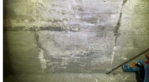
Saltutslag på mur.
