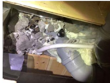
Ufagmessig utførelse observert på rørledninger under våtrom.
