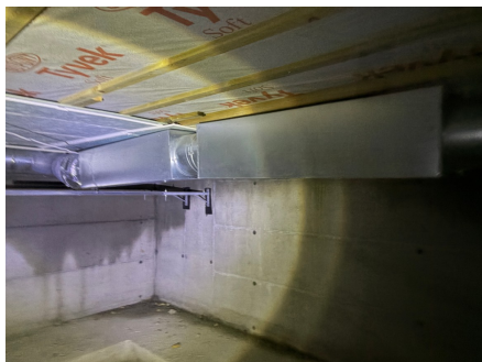
Stedvis kondens på grunnmur.
