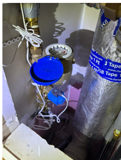
Stoppekran og vannmåler plassert i sjakt på soverom.
