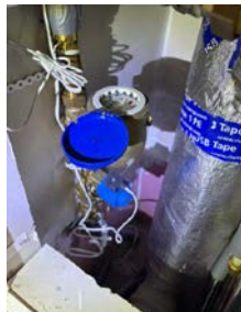
Stoppekran og vannmåler plassert i sjakt på soverom.
