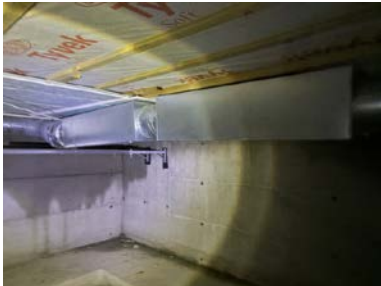
Stedvis kondens på grunnmur.
