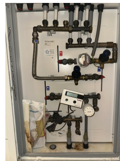
Samleskap med rørkurser og stoppekraner
