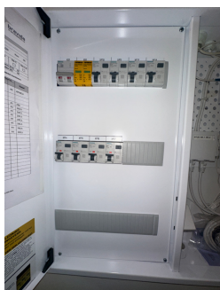
Sikringsskap med automatsikringer.
