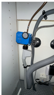
Rørøpplagg i kjøkkenbenk med Waterguard
