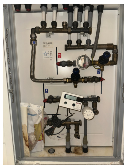
Samleskap for gulvvarme, plassert på bad
