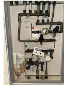
Samleskap med rørkurser og stoppekraner
