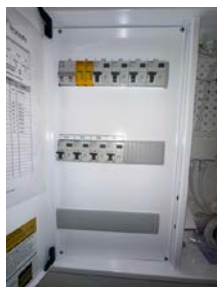
Sikringsskap med automatsikringer.
