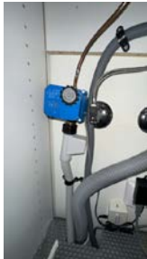
Røropplegg i kjøkkenbenk med Waterguard
