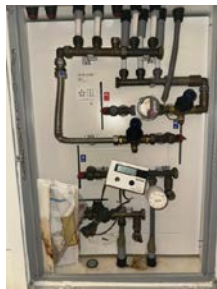
Samleskap for gulvvarme, plassert på bad
