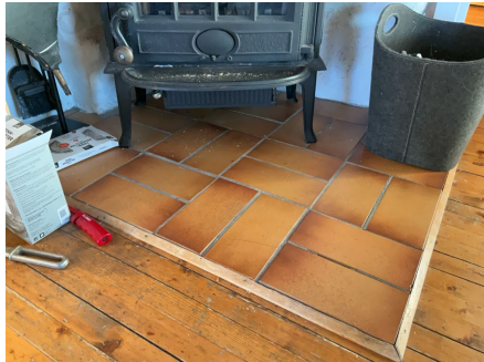
Sprekk i flis foran ildsted.
