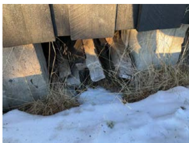
Det ligger organiske materialer direkte mot grunn som anbefales fjernet da dette gir sopp/råteskader.
