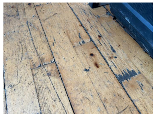
Slitasje på overflater
