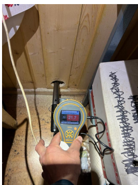
Hulltaking foretatt i innforet vegg mot yttermur, fuktutslag i konstruksjonen
