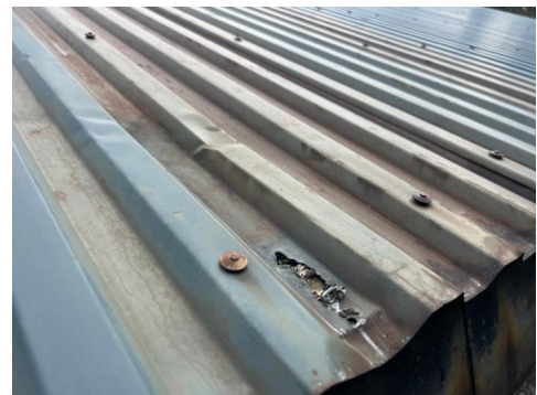
Skade på tekking som følge av avrevet takstige
