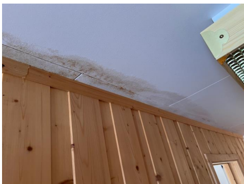
Fuktskjolder i himling i gang og kjøkken
