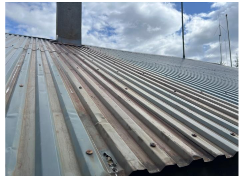
Slitasje på tekking
