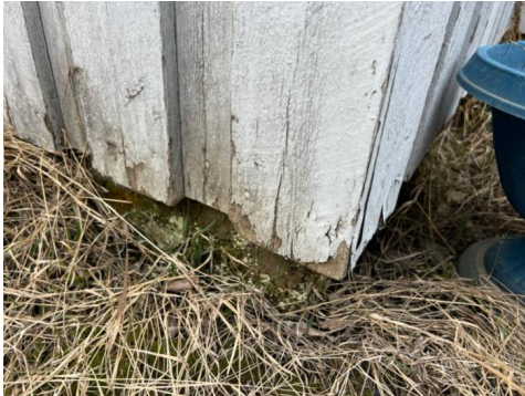
Slitasje på ytterkonstruksjon
