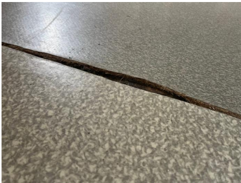
Slitasje på overflater
