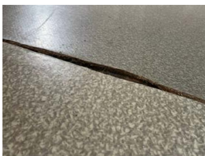
Slitasje på overflater
