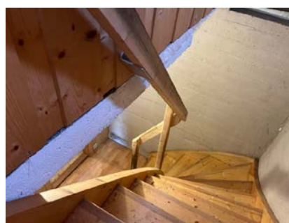
Ikke tilstrekkelig rekkverk
