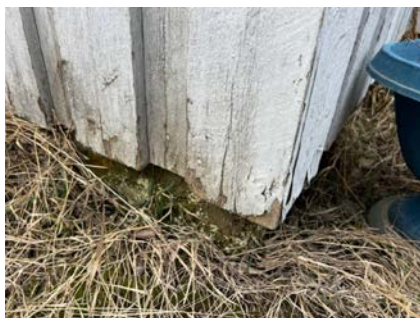
Slitasje på ytterkonstruksjon
