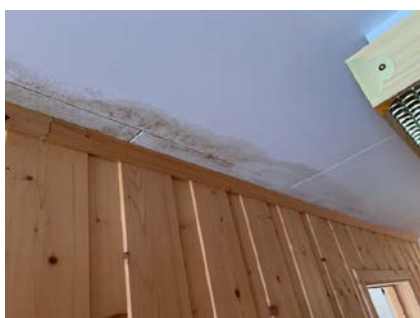
Fuktskjolder i himling i gang og kjøkken
