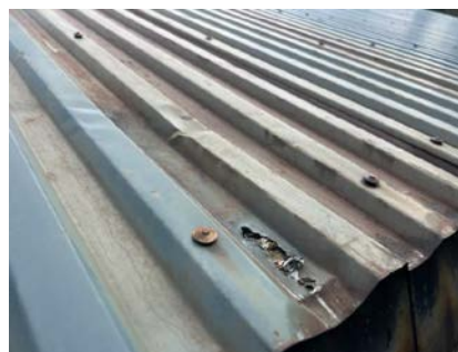
Skade på tekking som følge av avrevet takstige
