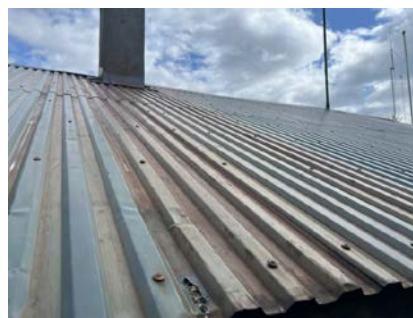
Slitasje på tekking
