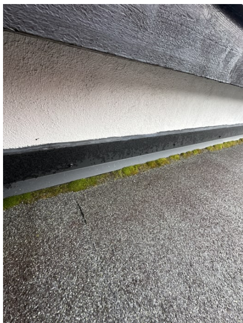
Det registreres mosegroing på taket. Dette reduserer levetiden på tekkingen.
