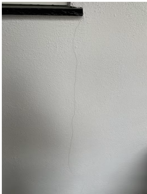
Viser sprekke i yttervegg ved inngangsparti.
