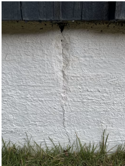
Viser sprekke i grunnmur.
