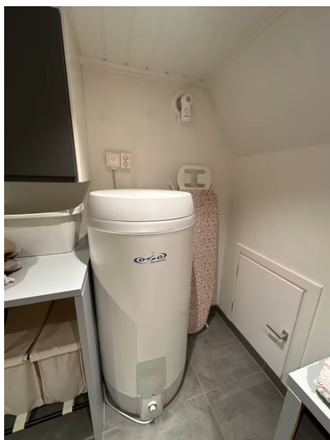
Viser plassering av varmtvannsbereder.
