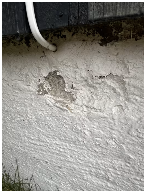
Viser avskalling av puss på grunnmur.
