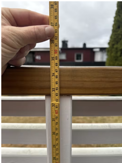
Viser rekkverkshøyde under krav.
